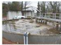
CHAUFFAILES bassin aération physique (DR-AMM)
