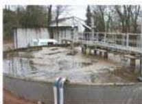
CHARENTAIS : bassin aération plancher diffuseur
