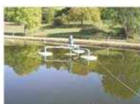
FUISSE - aérateur de lagunage à terre
