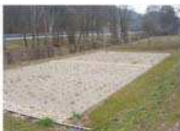
LA CHAPELLE AU MONT DE FRANCE Le horizontal en début de plantation de roseaux
