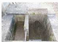
Dégrilleur et son by-pass ou déviation
